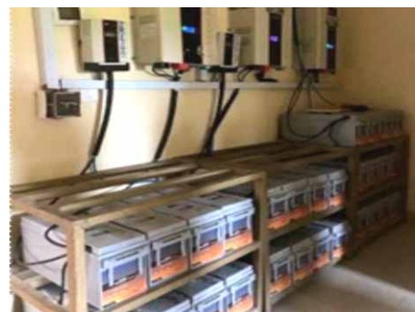
30 KVA Solar Power
